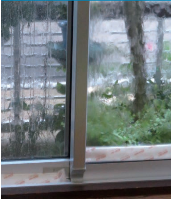
結露や台風時の吹込み水
