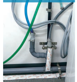
ビル内の給排水設備
